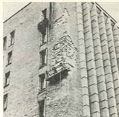
Fig. 15.02. Flisebeklædt facade; de manglende fliser er sprængt fra af frost.
