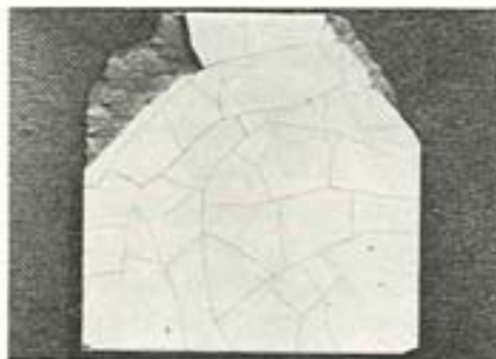
Fig. 15.11. Krakleret flise fra indvendig flisebeklædning opsat i for stærk opsætningsmørtel.
