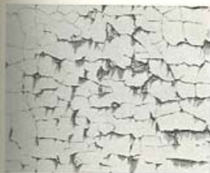
Fig. 11.01. Udvendigt malingslag, der skaller.
