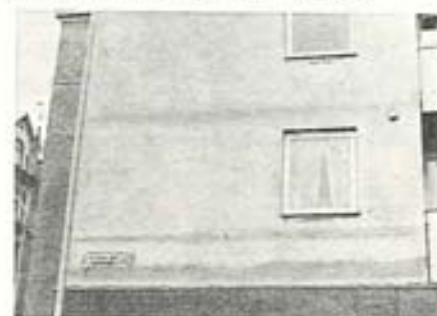
Fig. 13.05. Farveforskelle ved pudsskel.
