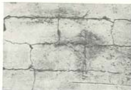
Fig. 9.05. Revner i puds over dårligt fyldte fuger.
