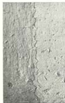
Fig. 9.32. Revnet puds over skel mellem gammel og ny mur.
