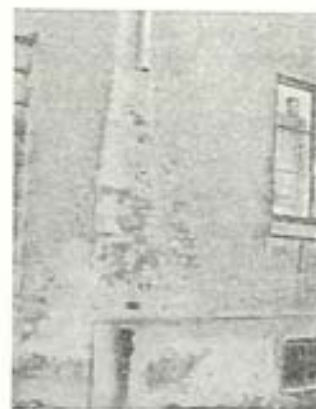
Fig. 13.11. Frostskadet puds under afbrudt nedløbsrør.
