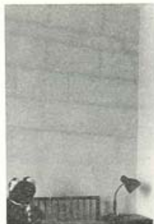
Fig. 13.08. Ydervæg med «støvlinier» på tapetet ud for «kolde» fuger.
