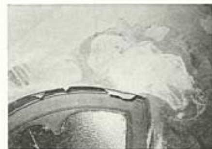
Fig. 11.04. Fugtskadet indvendigt malingslag.
