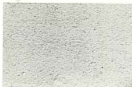
Fig. 11.05. Ikke dækkende malingslag på grupporet underlag.
