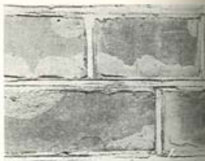
Fig. 13.25. Teglstensfacade med afskalling fra stenkantene og langsgående revner i fugerne. Fugemørtlen er svulmet på grund af forkert syrebehandling.
