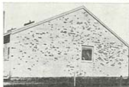
Fig. 11.02. Frostskafer i facadestenen i teglvæg med for tæt malingslag.
